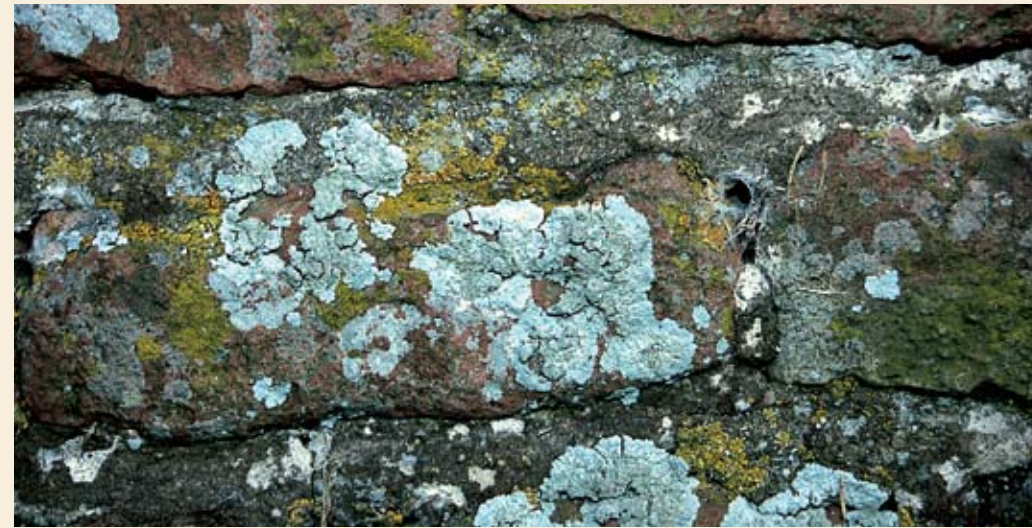
Korstmossen zijn vaak de eerste pioniers op muren
